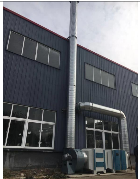
图 3-2 覆膜、拼版工序废气排气筒
