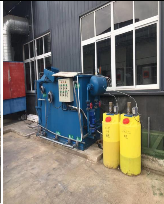
图 3-4 生产废水处理设施
