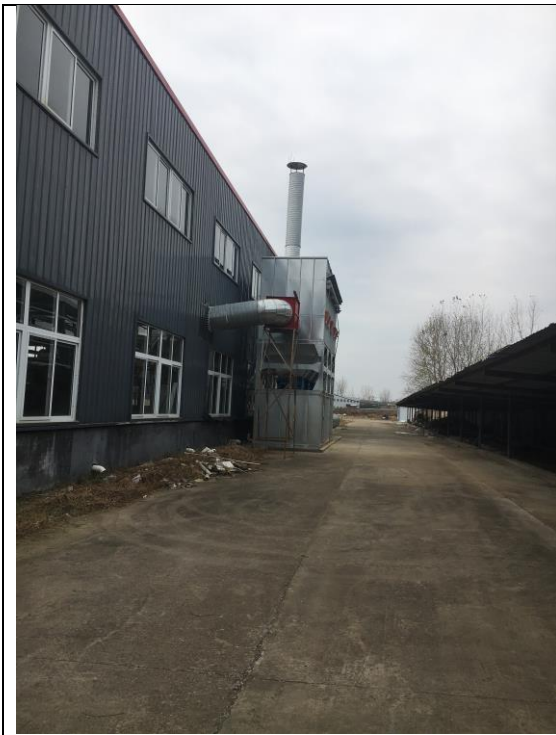
图 3-1 开板、切边、刨型等工序废气排气筒
